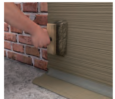
6 步骤6：然后再施工一层碧林®防水砂浆，完成建筑避潮层修复。
