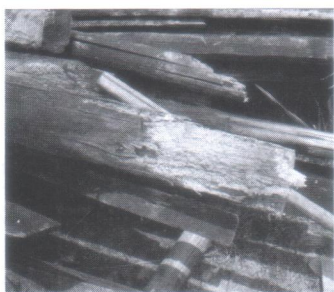
图 12 因蛀蚀和腐朽被弃置的木构
