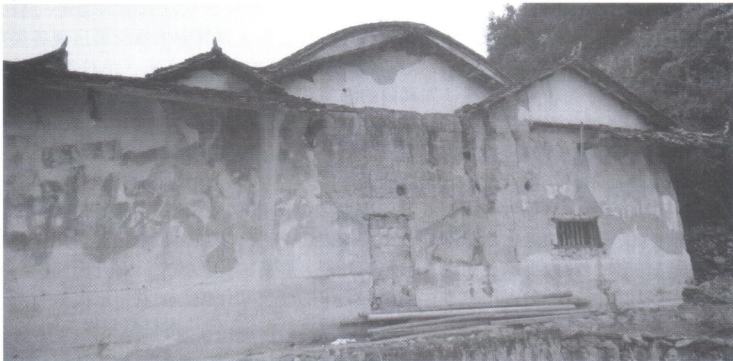
图2：屋面坍塌导致墙体标语的损坏
