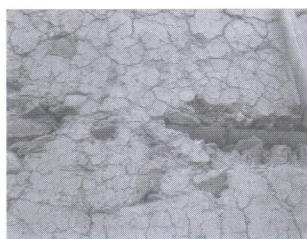
图4：夯土墙表皮龟裂
