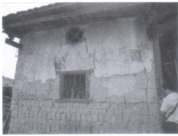
图 6: 石灰表皮大面积脱落 危及标语安全
