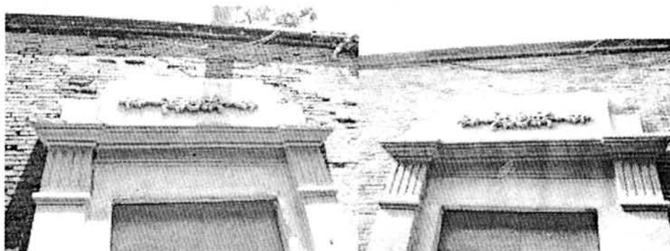
图 13 采用天然水硬性石灰修复的水刷石石库门 (杭州九星里 1 号修复前后)
