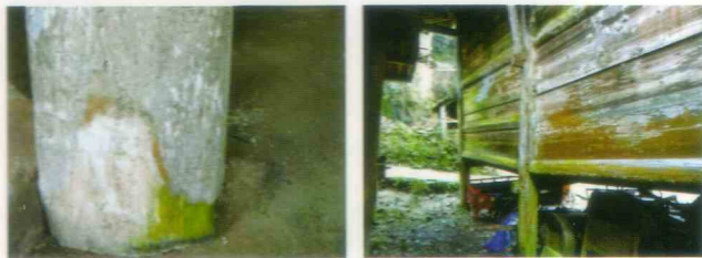
图2 木柱根部吸水出现腐朽、青苔(图片来源:作者自摄)
