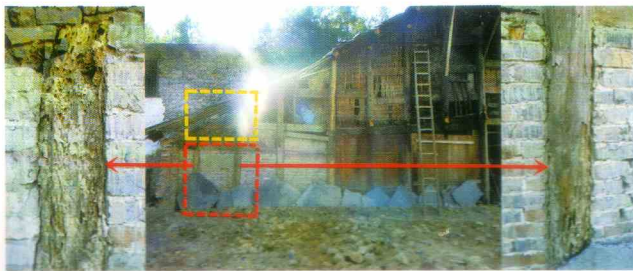
图1 置于墙内木柱出现腐朽、虫蛀等病害(图片来源:作者自摄)
