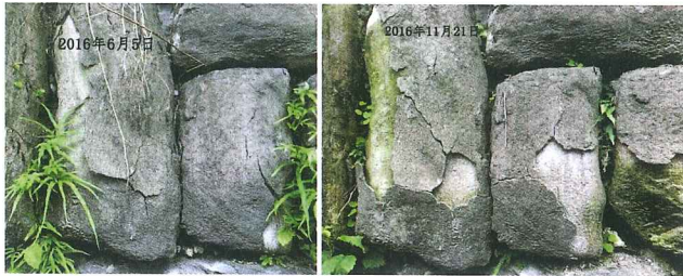
图9 采用所谓“防风化”处理的砂岩（左），在10余年后出现的无法修复的病害（右）
