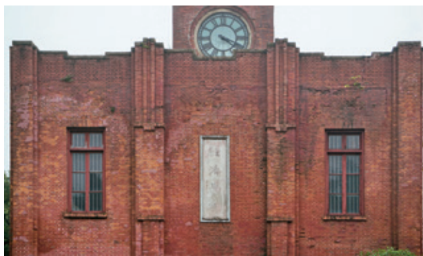
原之江大学旧址钟楼修复前
